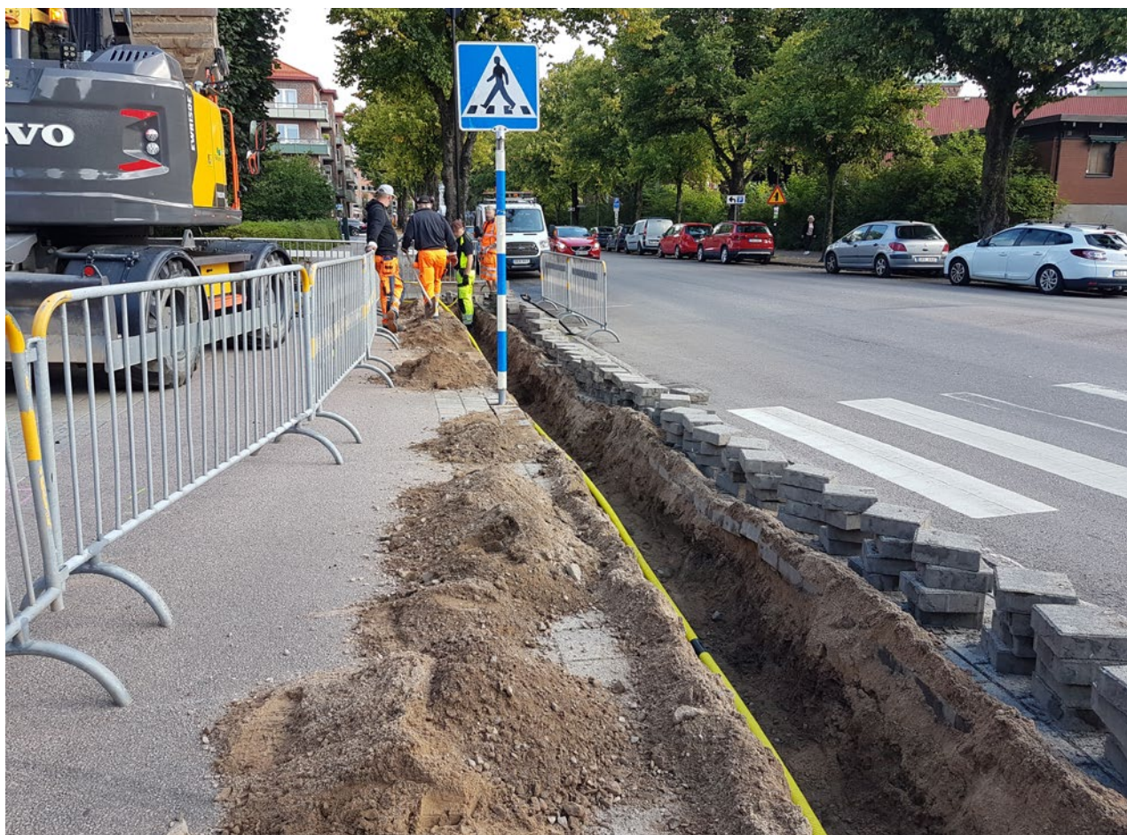
Figur 5. Schakt längs Karl XI:s väg. (Fotonr 2024-075-3). Foto mot norr. Foto Patrik Hallberg.
