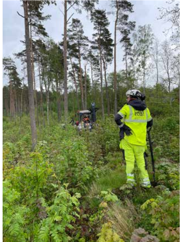
Figur 12. Jonas väntar in Jakob i grävmaskinen som långsamt tog sig fram genom den kuperade och slybeväxta terrängen. Foto mot nordöst (Fotonr: 2024-43_9). Fotograf: Linda Wigert
