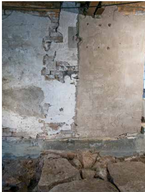
Figur 7: En sotfläck syns på väggen över stenfundamentet där putsen lossnat. Fototr.: 2022-24:53 Foto: Sofie Renström
