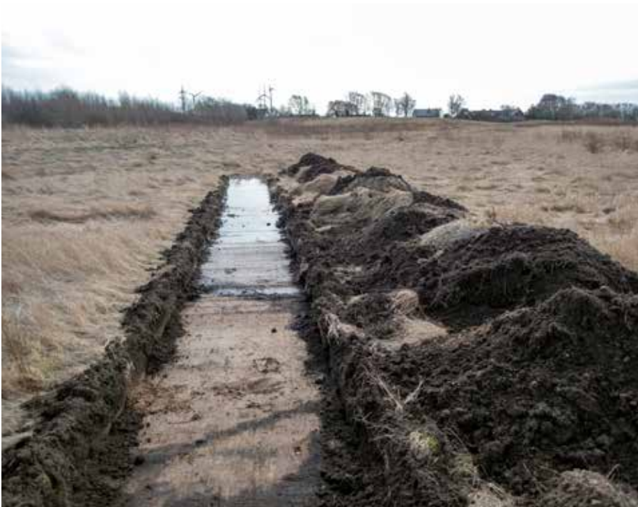
Figur 11. Översikt vid OS447. Vatten kryper upp i södra delen av schaktet. Mot syd. Foto nr 2023-65-6. Jonas Carlsson.
