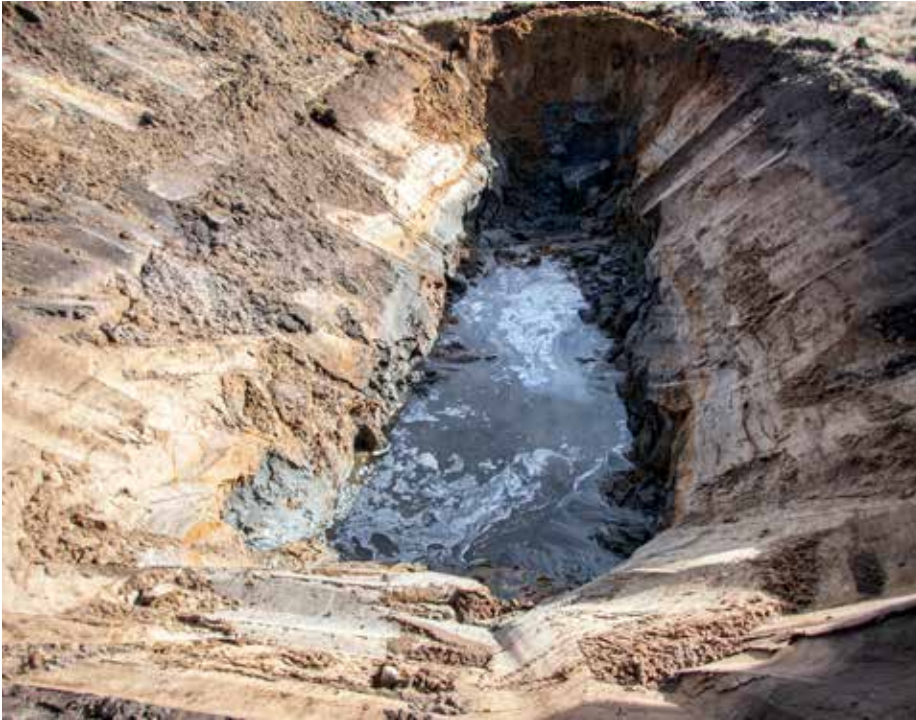
Figur 10. Djupschakt OS459. Vatten kryper upp i botten av schakt. Mot sydöst. Foto nr 2023-65-5. Jonas Carlsson.
